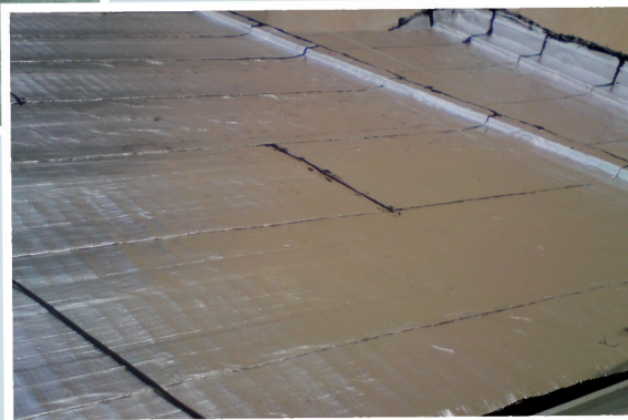
Manta alumínio em telhado de zinco
